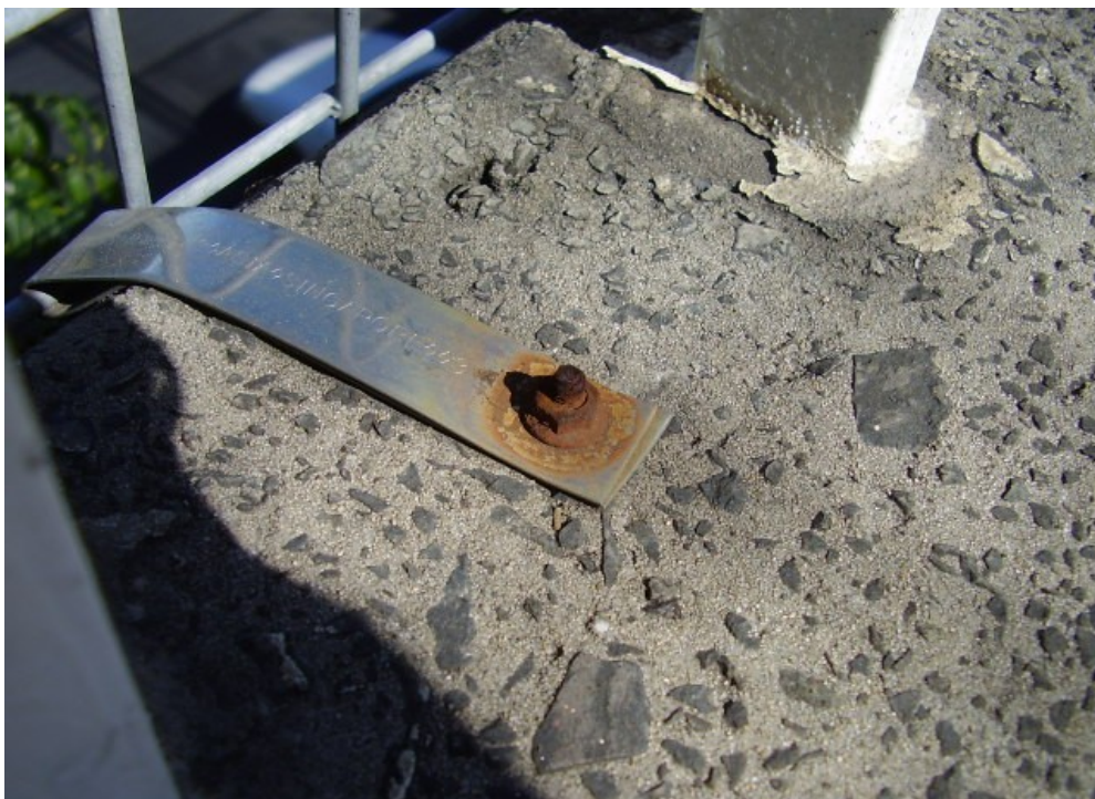
Corrosion of bolt.
